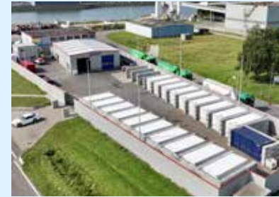
Humberweg 5 A&M Batteries
