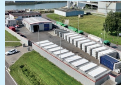
Humberweg 5 A&M Batteries
